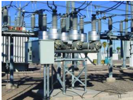
Disjuntores de tanque morto, uma aplicação típica
