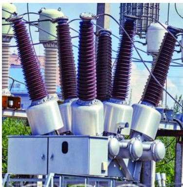
Disjuntor de alta tensão em serviço, com as buchas e o mecanismo de manobra onde o BPM realiza as suas medições.
