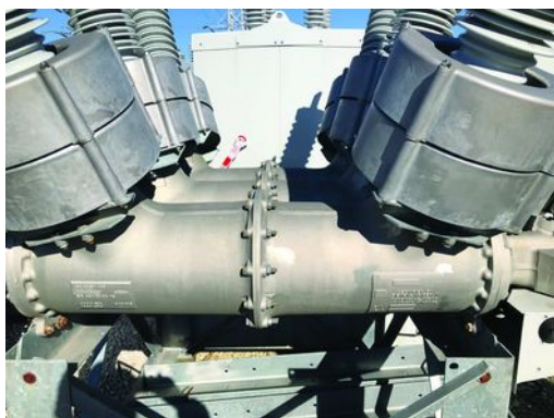
Mecanismo de manobra e disjuntor de alta tensão, com o sistema de energia armazenada monitorizado pelo BPM.
