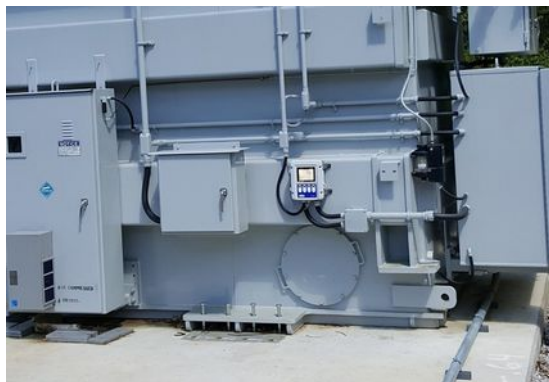
O B100 instalado no quadro de controlo de um transformador, junto a outros equipamentos auxiliares.
