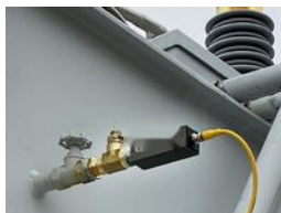
Sensor de hidrogénio instalado na válvula de recolha de amostras de óleo do transformador.
