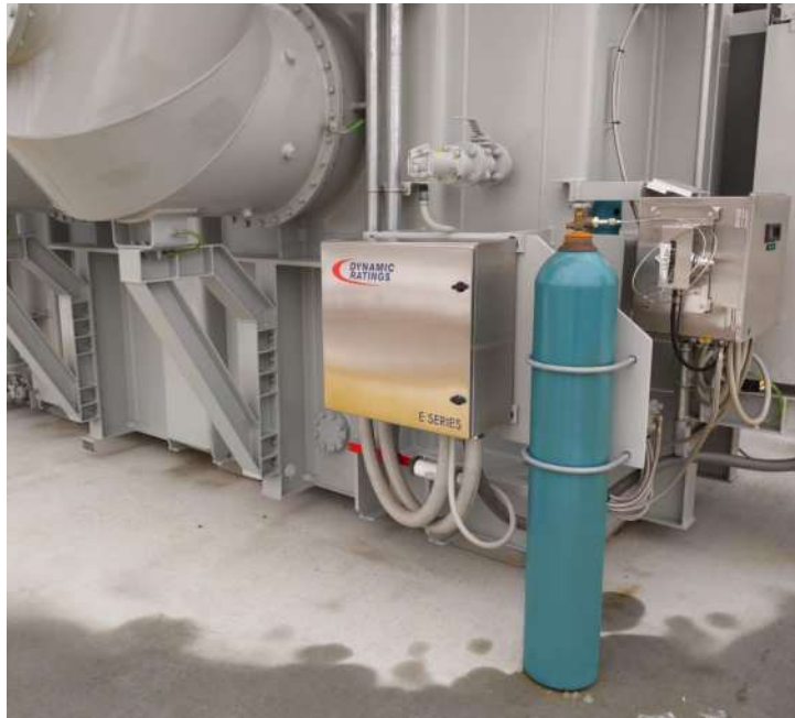
E Series instalado num transformador de potência
