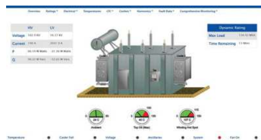
Vista geral do transformador
