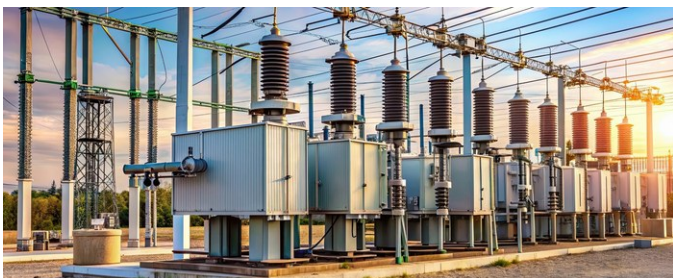
Monitorização permanente da frota de transformadores, sem deslocações para recolher amostras de óleo.
