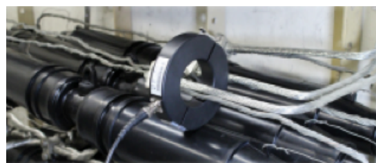
PINZAS PARA DESCARGAS PARCIALES PUESTA A TIERRA
